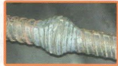
۱- آرماتور جوشکاری شده به روش Gas Pressure Welding که ظاهراً اتصال بسیار خوبی انجام شده است
